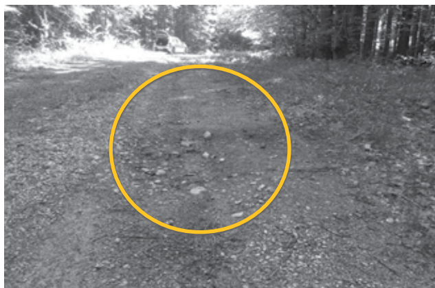
Slika 2. Udarne rupe na dijelu šumske ceste
