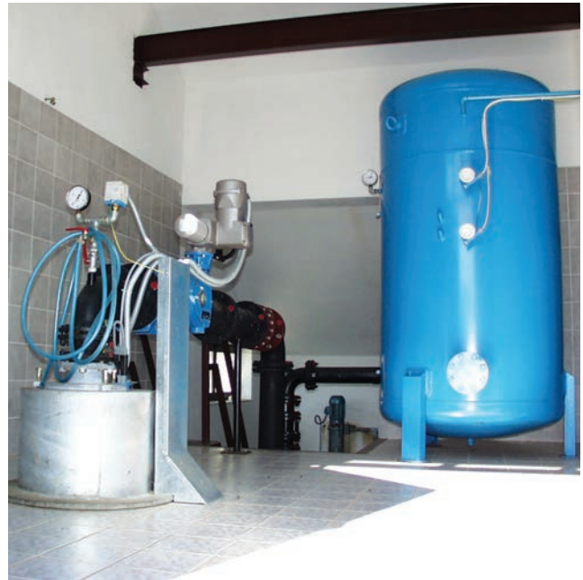
Strojarnica crpilišta Luke
