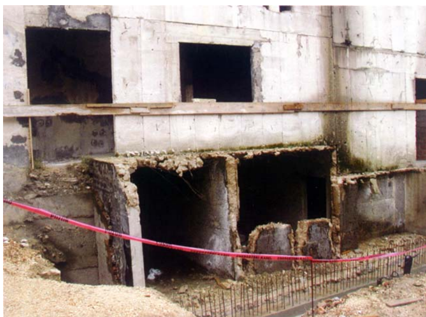
Detalji oštećenih zidova
