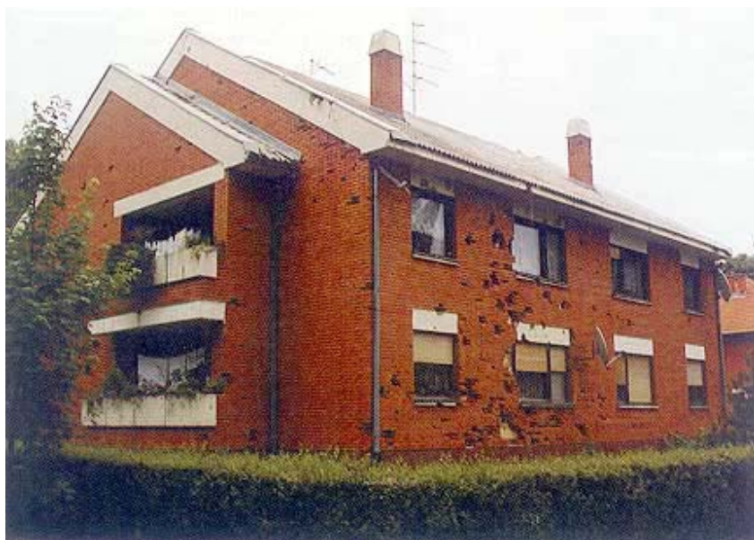
Zgrada u ulici A. Starčevića A2/2 u Borovu naselju prije početka obnove
