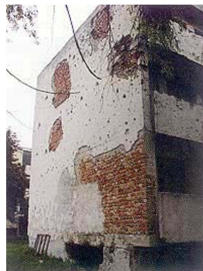
Oštećenja na zgradi u Županijskog ulici 120 i 122
